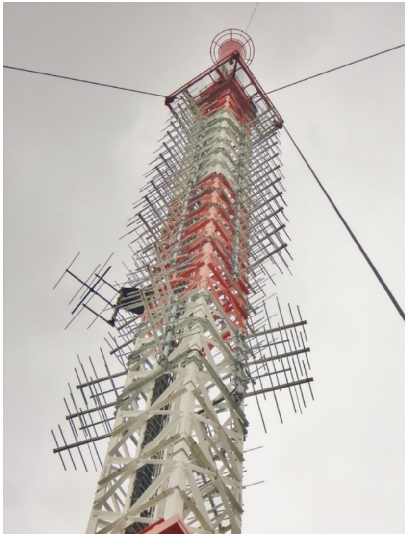
im Bild: Windlastarme UKW LogPer Antennen an der Station "Wittenberg"
